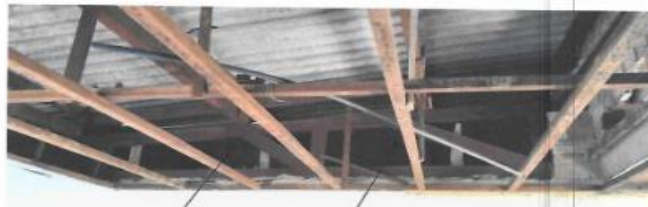
FOTO 13. Estrutura – Madeiramento executado em desconformidade normativa.
