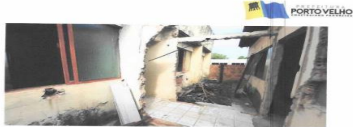
FOTO 10. Estrutura – Execução fora de norma.
