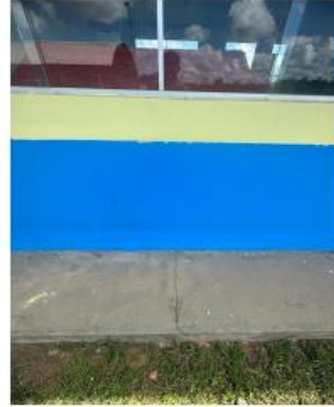
Imagem 8 - Rachadura na calçada externa
