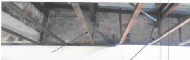
FOTO 14. Estrutura – ausência de pilares e cintas. Estrutura apoiada na alvenaria.
