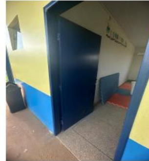
Imagem 10 - Portas do tipo semi oca com sinais de absorção de umidade e inchadas na parte de baixo
