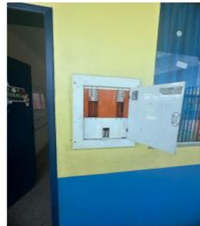
Imagem 14 - Quadro de energia das salas de aula e banheiros construídos
