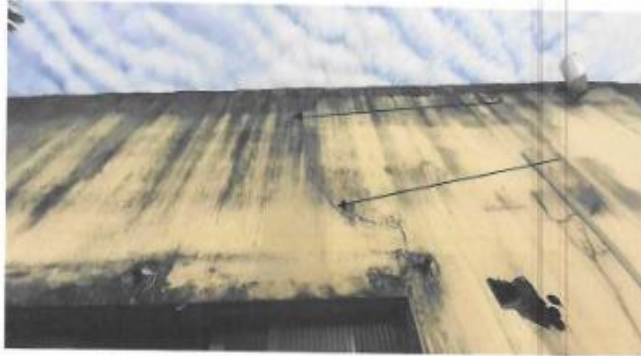
FOTO 07. Estrutura – Ausência de cinta de amarração.
