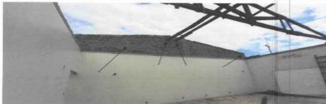
FOTO 12. Estrutura – ausência de pilares e cintas. Estrutura apoiada na alvenaria.
