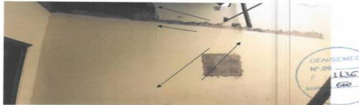
FOTO 11. Estrutura – Rompimento da alvenaria/ Ausência de Estrutura.
