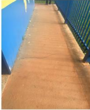
Imagem 8 - Rachadura na calçada externa
