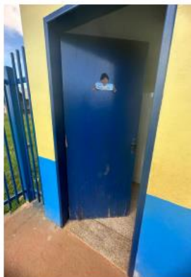
Imagem 15 - Portas do tipo semi oca com sinais de absorção de humidade e inchadas na parte de baixo
