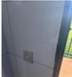
Imagem 9 - Cerâmica trincada do banheiro
