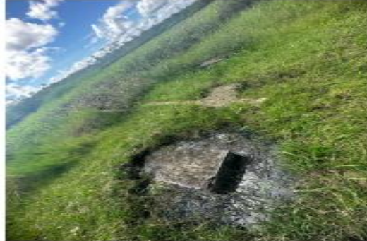
Imagem 11 - Fossa com sumidouro transbordando
